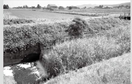
— 西大谷川沖地内に堆積した土砂 —
