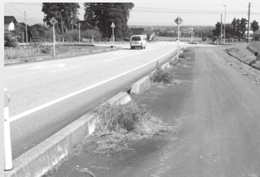
－院瀬見地内広域農道の枯死低木－
