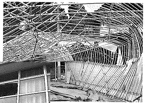
体育館のガラスも3枚割れました
